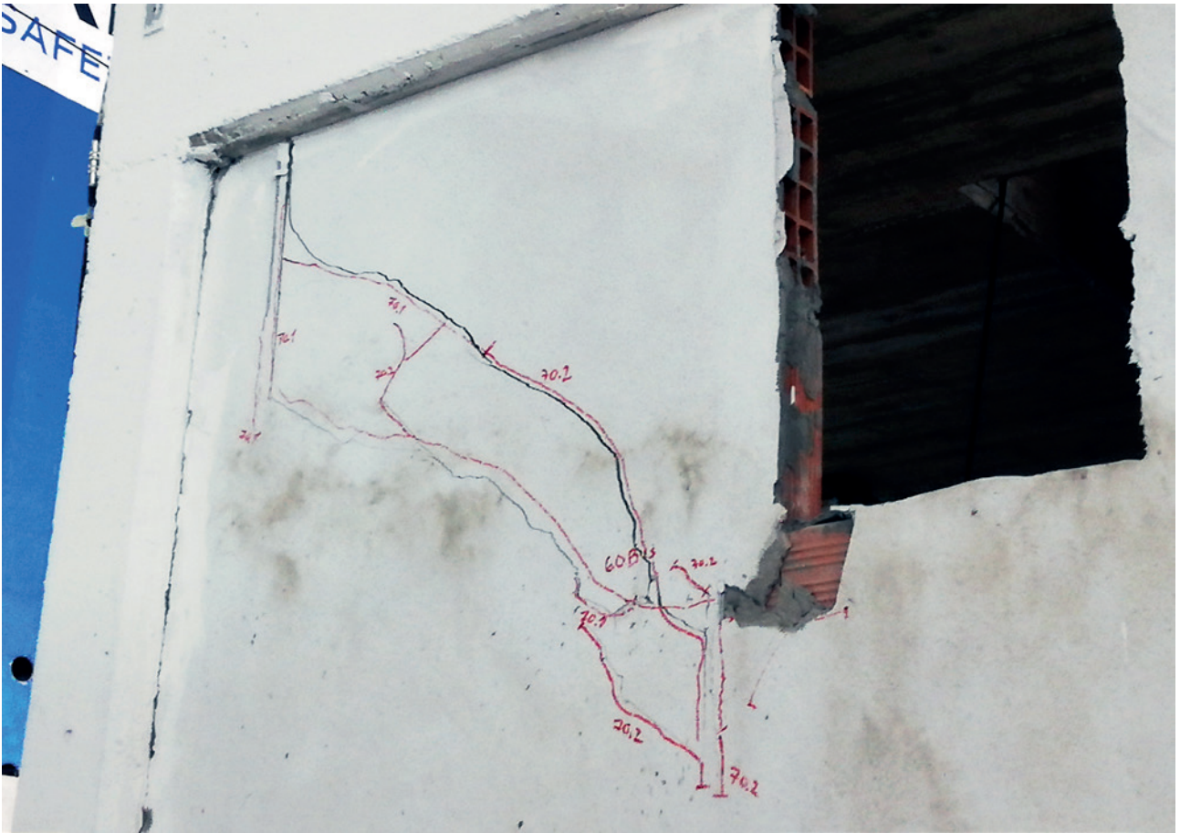
Danni agli elementi non strutturali dell'edificio privo del sistema I-Pro 1 dopo il sisma 0.27g.
