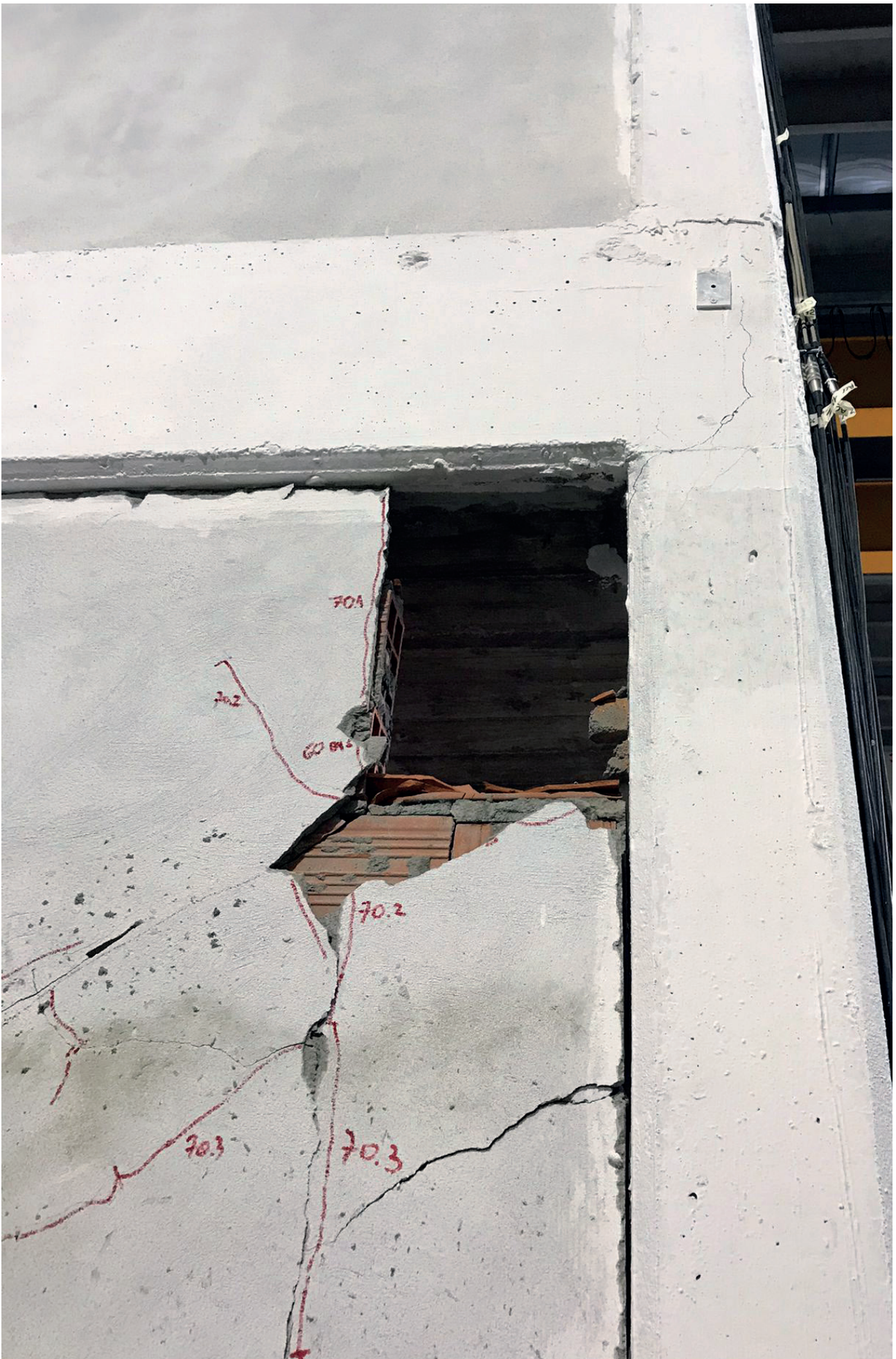
(g) Danni agli elementi strutturali e non strutturali dell'edificio privo di I-Pro 1 dopo il sisma 0.44g delle porzione anteriore-destra;
