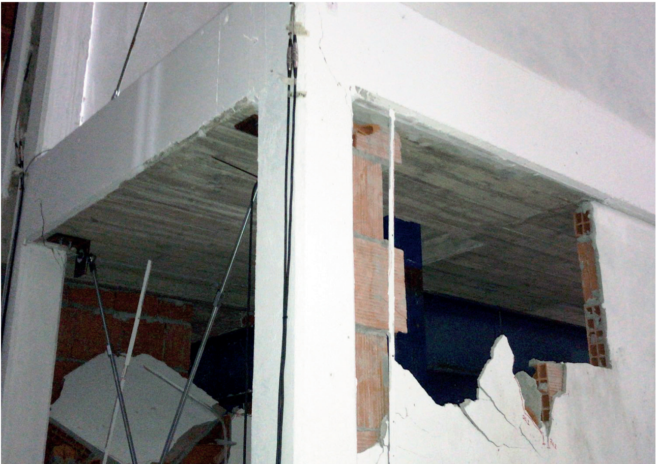
(d) Danni agli elementi strutturali e non strutturali dell'edificio privo di I-Pro 1 dopo il sisma 0.44g delle porzione posteriore-destra.
