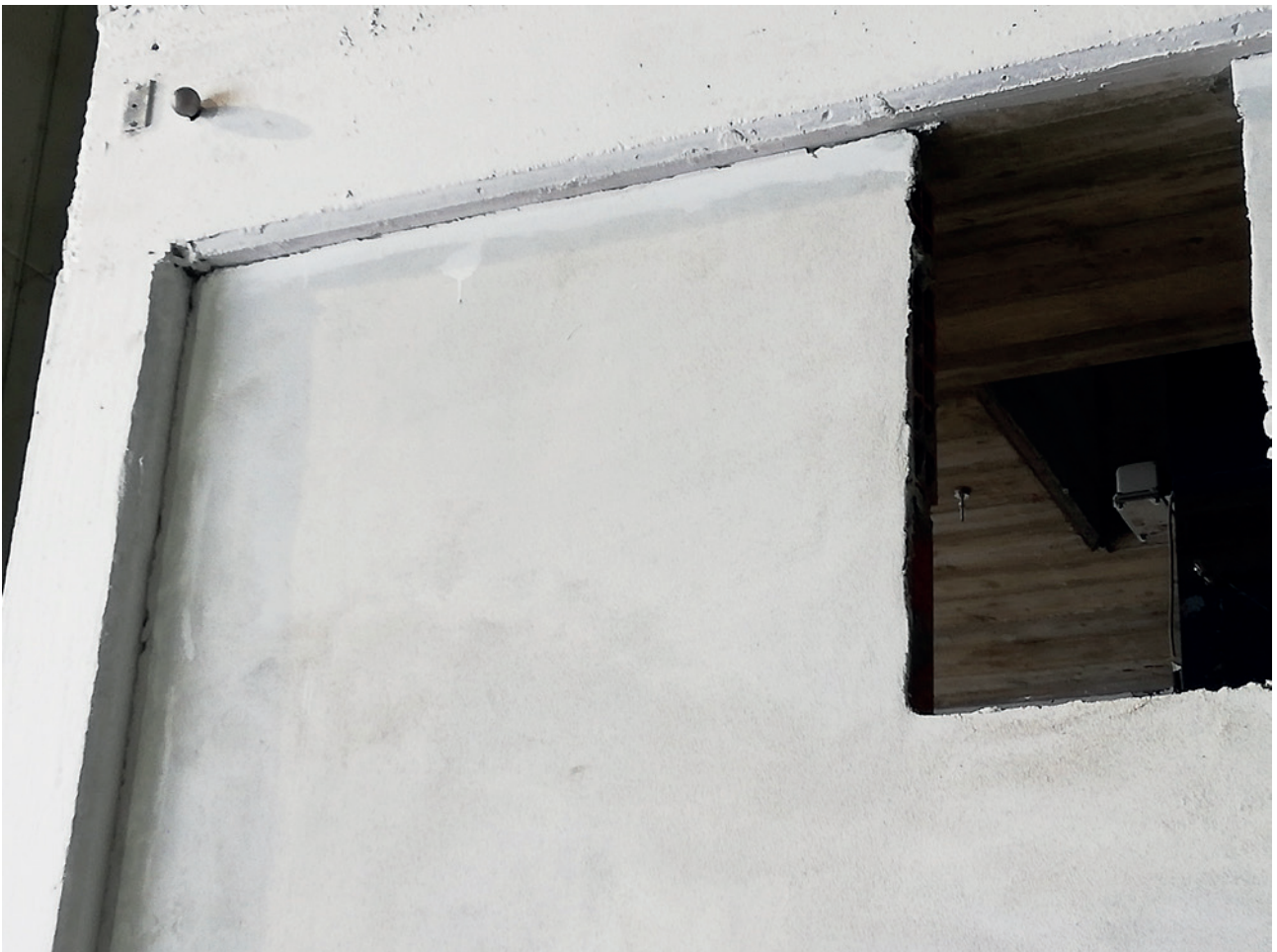
(c) Danni agli elementi non strutturali dell'edificio con il sistema I-Pro 1 dopo il sisma 0.27g.
